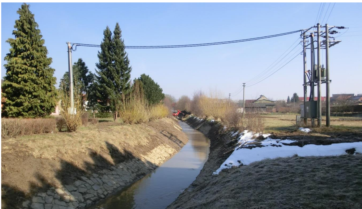
Rozvody elektrické energie před rekonstrukcí
